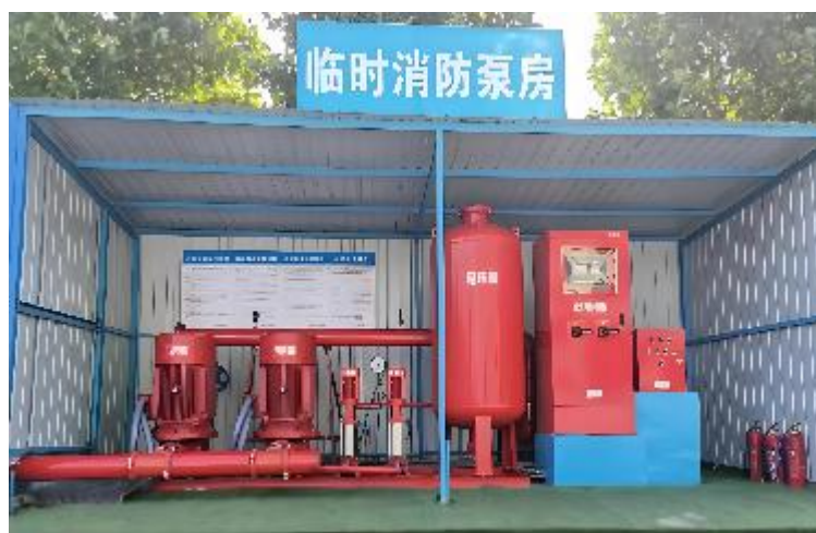
图 6.5.4-1 临时消防泵房
