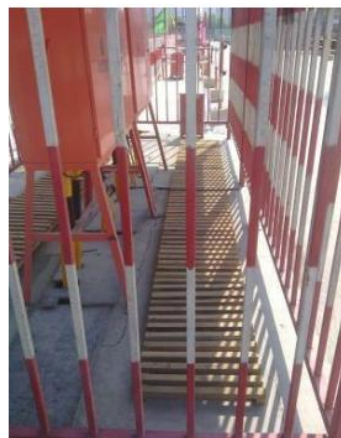
配电箱防护棚实景图
