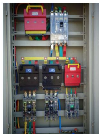
分配电箱实物图
