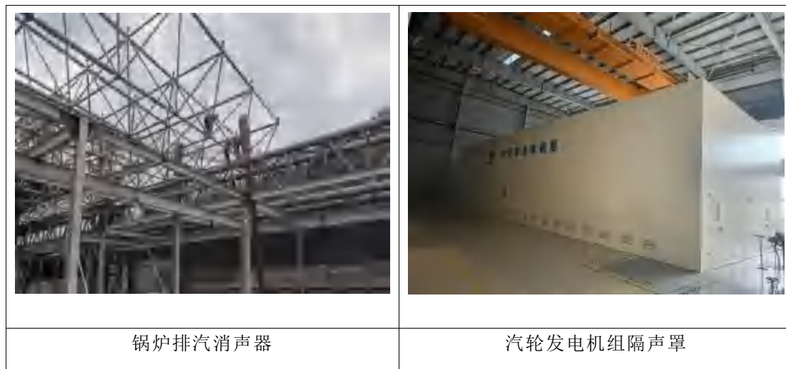
图 3.6-6 噪声治理措施现场实拍图
