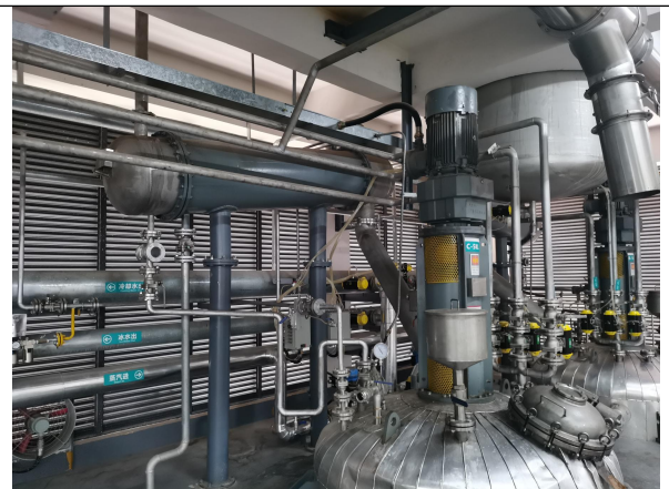
树脂生产线-反应釜配套冷凝管
