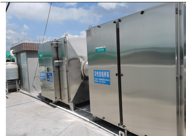
树脂生产线-治理设施 (UV+活性炭)
