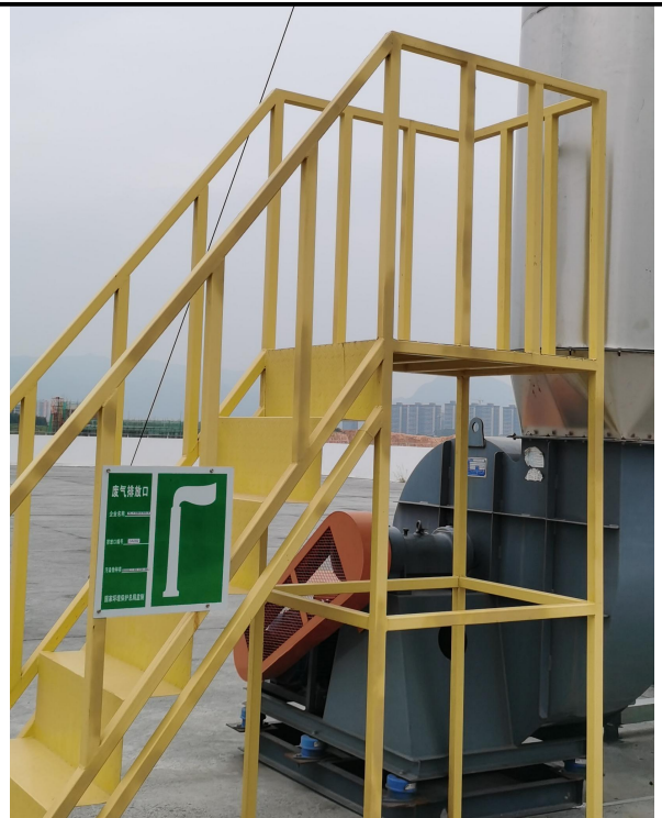
主厂房——排气筒 (DA002) 标志牌
