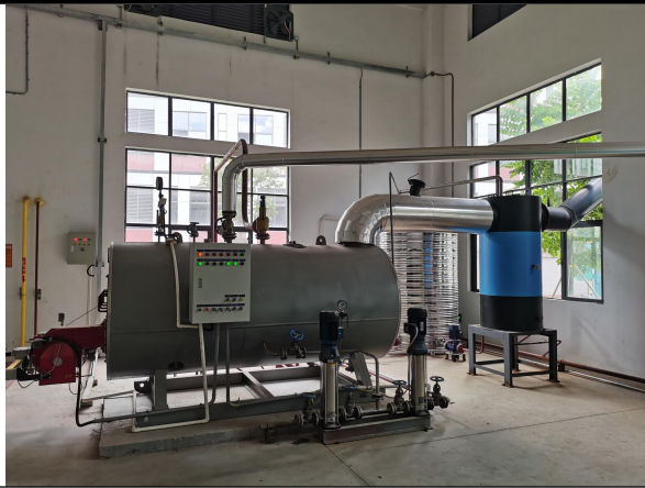
公用工程—锅炉房（蒸汽锅炉）
