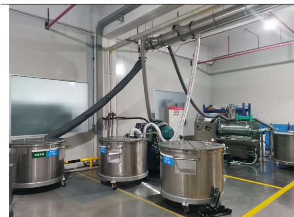
主厂房—磨色浆区（含放空管道）
