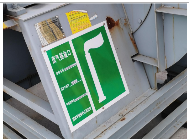
树脂生产线——排气筒 (DA001) 近景
