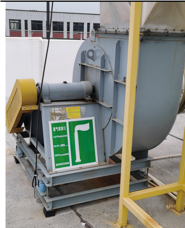
主厂房——排气筒 (DA003) 标志牌
