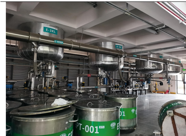
树脂生产线-反应釜底部卸料口
