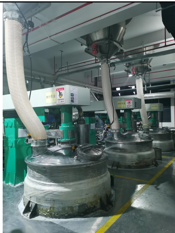
主厂房—分散机（含放空管道）
