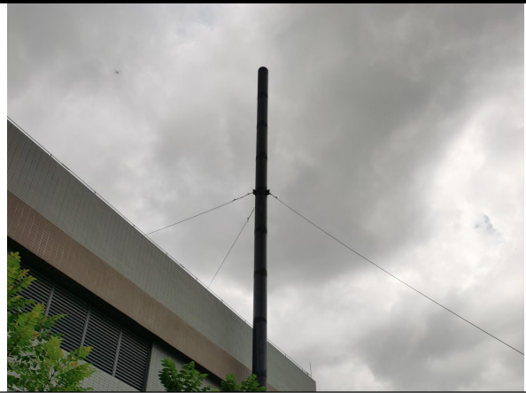
公用工程—蒸汽锅炉排气筒（DA004）
